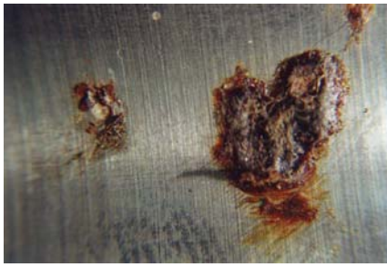
Perfuração associada à matéria orgânica (marrão) aderida à superfície de um tubo de aço inoxidável.
