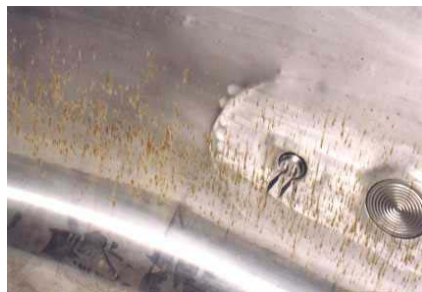
Contaminação superficial com ferro no interior de um tanque de aço inoxidável, provocada por incidência de partículas de ferro durante o esmerilhamento de uma chapa de aço carbono.
